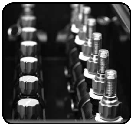
Verteilerschacht Typ WM mit Durchflussmesser
